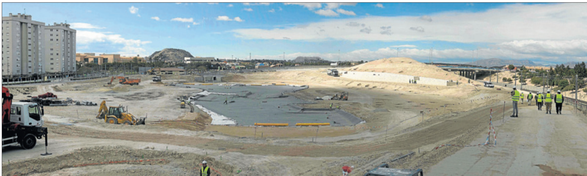
Los técnicos calculan que el parque El Marjal se podrá visitar a partir del próximo verano. Las obras finalizarán en junio. RAFA ARJONES
