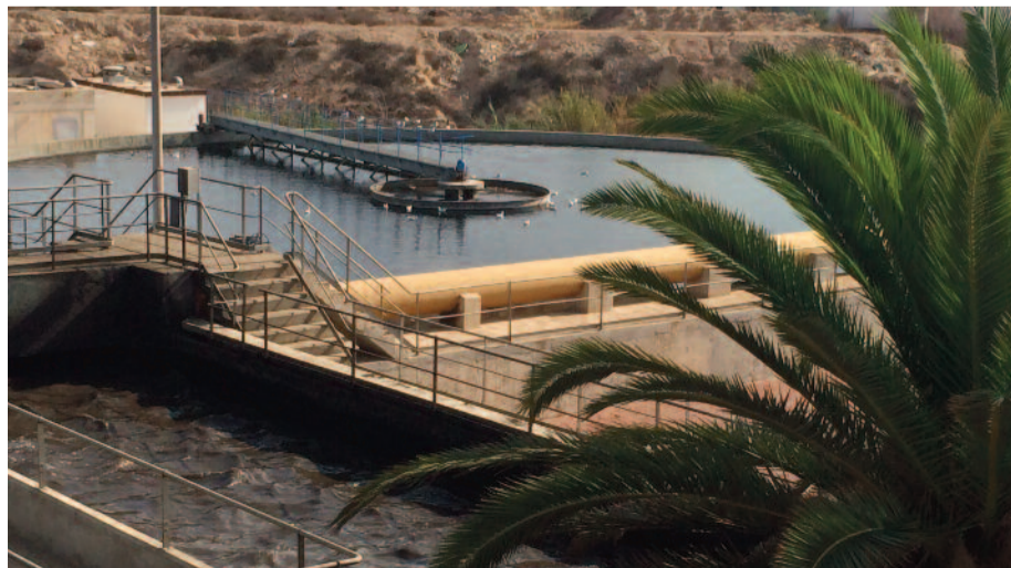
La depuradora del Rincón de León.
