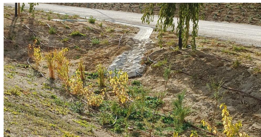
Figura 21. Caz encachado para disipación de energía y control de la erosión en una entrada puntal a un jardín de lluvia (Parque Ferial de Fuenlabrada).
