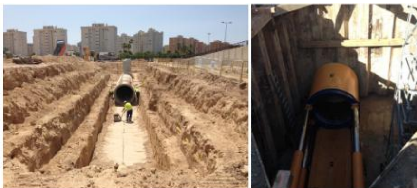
Figura 33. Conducción de entrada al parque La Marjal, Alicante. Fuente: Aguas de Alicante.
