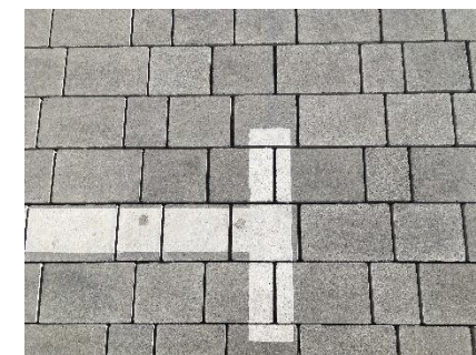
Figura 45. Pavimento permeable por junta en Parque de Esplai, Bétera.
