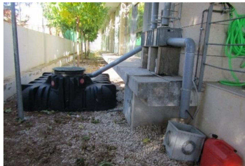
Figura 13. Aljibe semienterrado en el Centre Social de Benaguasil (Valencia).
