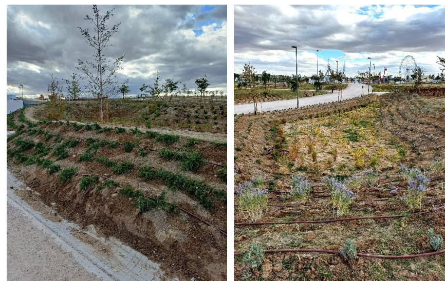
Figura 39. Izquierda: arrastre de sedimentos por erosión en taludes de reciente plantación. Derecha: riego frecuente durante los meses posteriores a la plantación. (Parque Ferial de Fuenlabrada).
